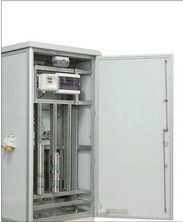
Kabelschrank zur Versorgung und Steuerung der Antriebe für die Schalter der Hoch- und Mittelspannungs-Umspannwerken sowie zur Übertragung von Daten aus den Messkreisen
